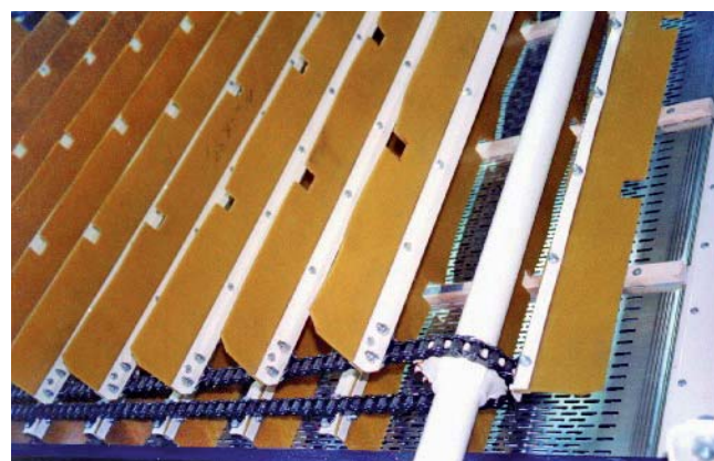
Sistema de limpieza por cribas
