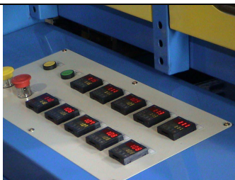
Panel de Control, sistema de control de temperatura.
