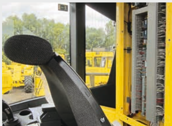
Centro de control bien protegido en la cabina.
