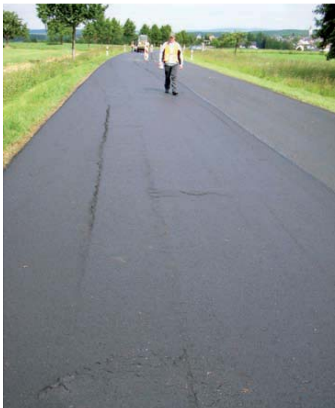
Fig. 80 Grietas transversales y longitudinales debido al uso de un rodillo demasiado pesado
