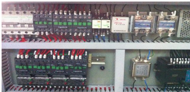
Sistema eléctrico. PLC y componentes Schneider.
