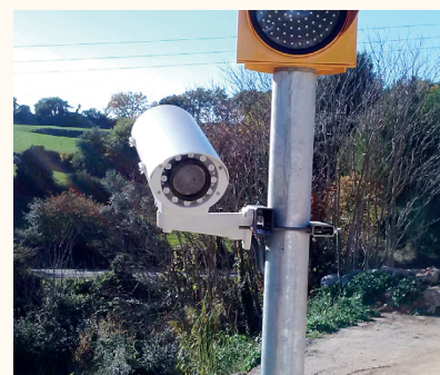
CÁMARAS CCTV Y ANPR
