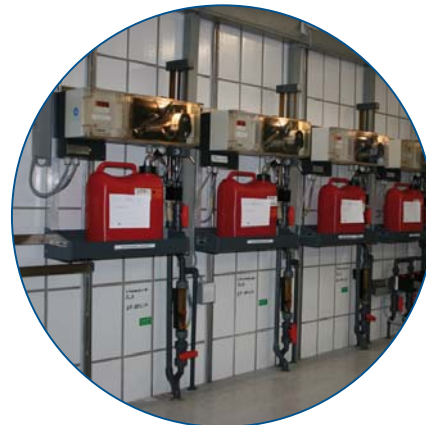
Fig. 3: Estación de calidad del agua con completa tecnología de medida de proceso
