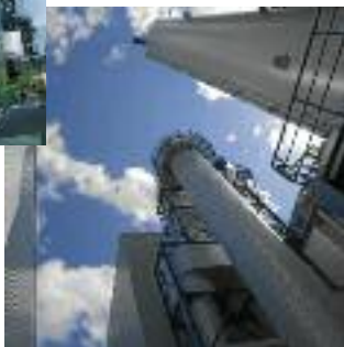
Generación de energía
