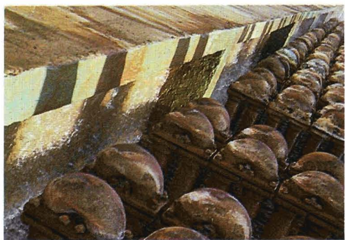
Revestimiento anticorrosivo en la bandeja de una planta de sulfúrico.
