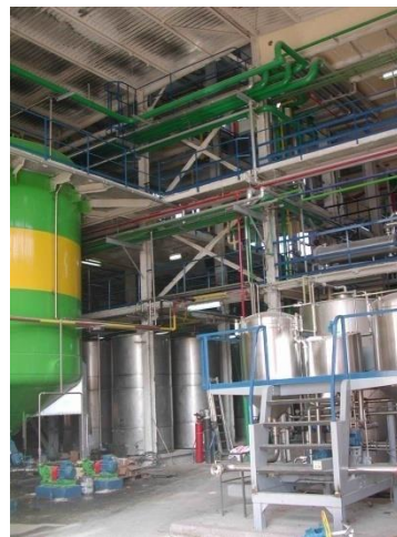
Reactor de metóxido
