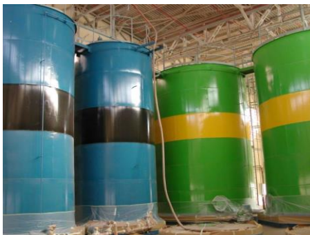
Depósitos de almacenamiento de glicerina y biodiesel
