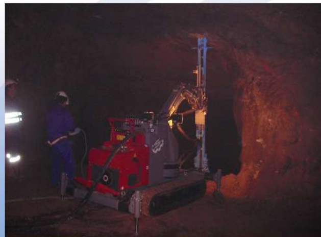
EPO 10-A en mina interior (Asturias)
