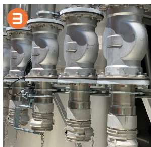
Sistema seguridad de carga de silos
