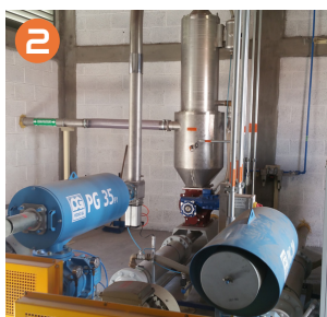
2 Carga aspiración / impulsión des de ferrocarril a silos.
